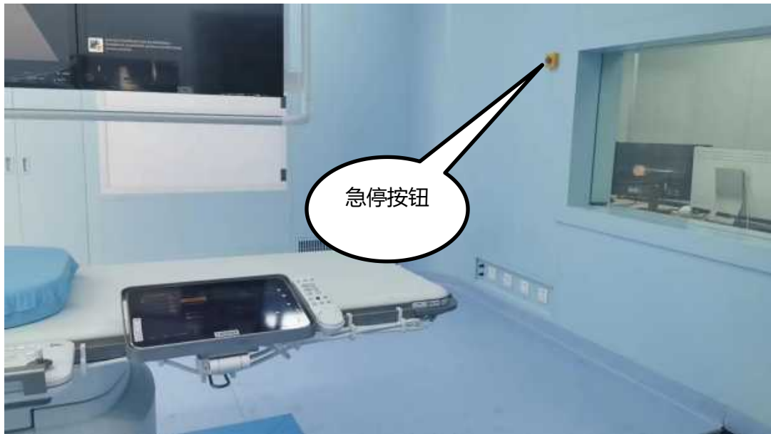
DSA 机房内墙面急停按钮
